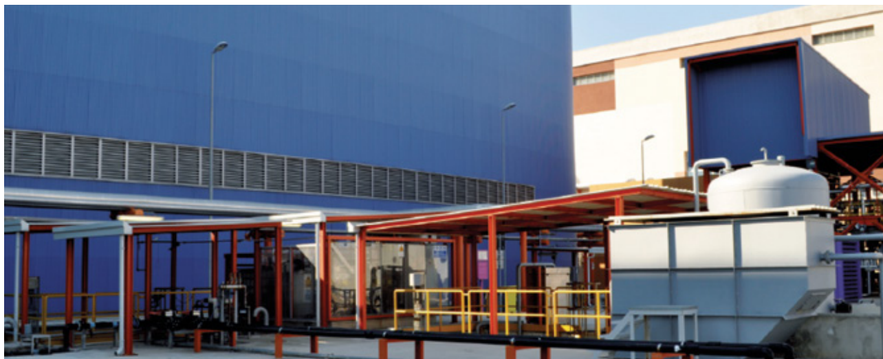
Figura 13: Impianto di Trattamento delle Acque Reflue
