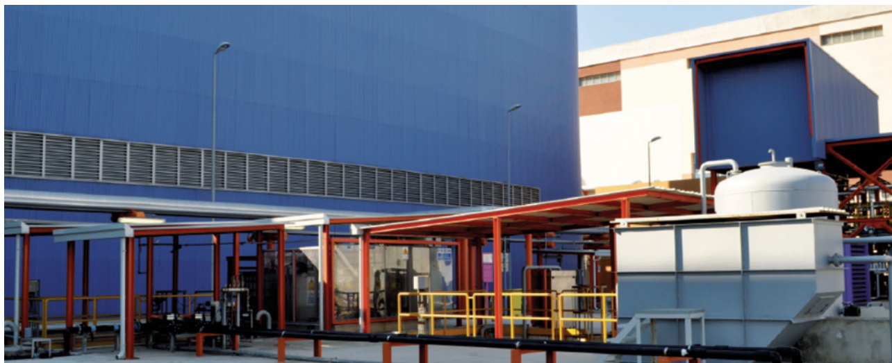
Figura 13: Impianto di Trattamento delle Acque Reflue
