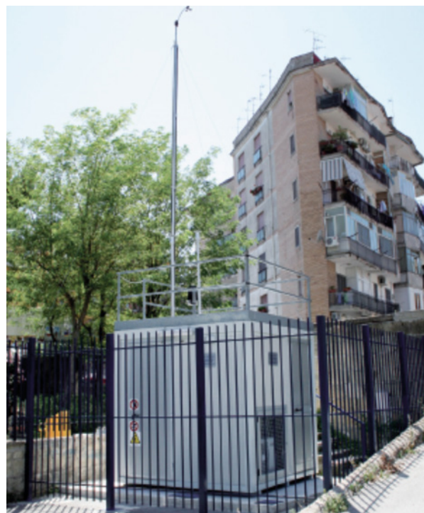
Figura n. 11: Centralina di Via Epomeo
